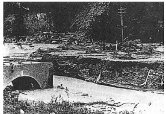
土石流によりこわれた堤防や道路(妙法寺川)
