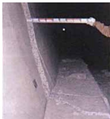
兵庫県南部地震によってずれたトンネルの様子(横尾山断層付近)
