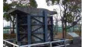
⑥山陽電鉄跨線橋の被災 橋脚 (須磨海浜公園)
