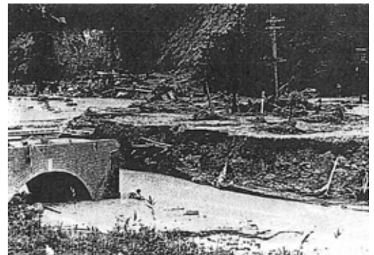
土石流によりこわれた堤防や道路(妙法寺川)
