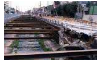
新湊川の川岸の被害
