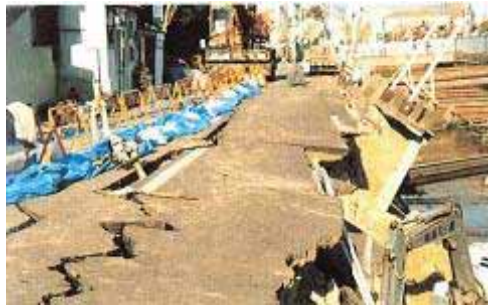
護岸が崩れる(室内橋下流付近)
