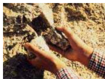
崩れやすい状態
