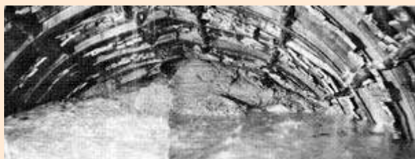
くず 崩れ落ちた土砂
