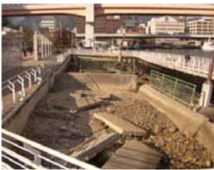
「崩れ落ちた岸壁」 神戸港震災メモリアルパーク
