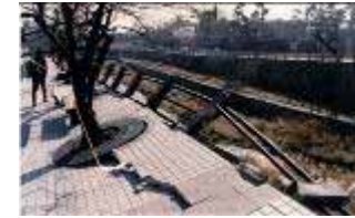
芦屋川の川岸の被害
