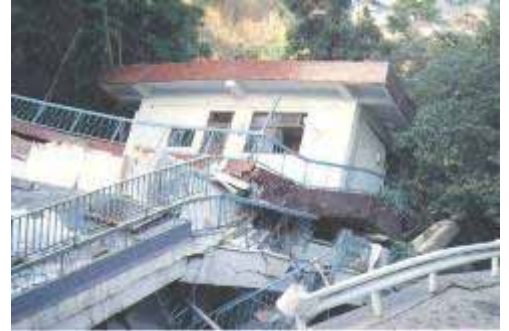
阪神・淡路大震災の被災状況(北区有馬町)
