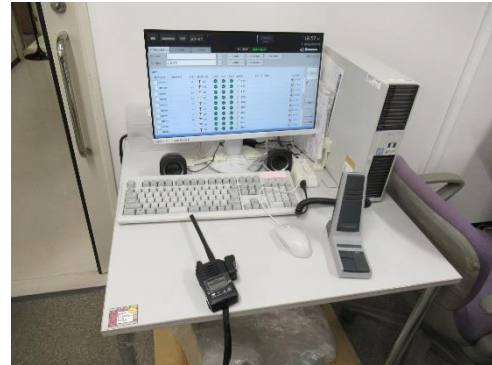
K-1 遠隔通信装置の動作確認
