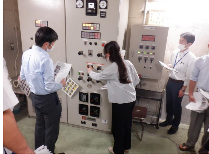
非常用予備発電設備(発電機)の点検
