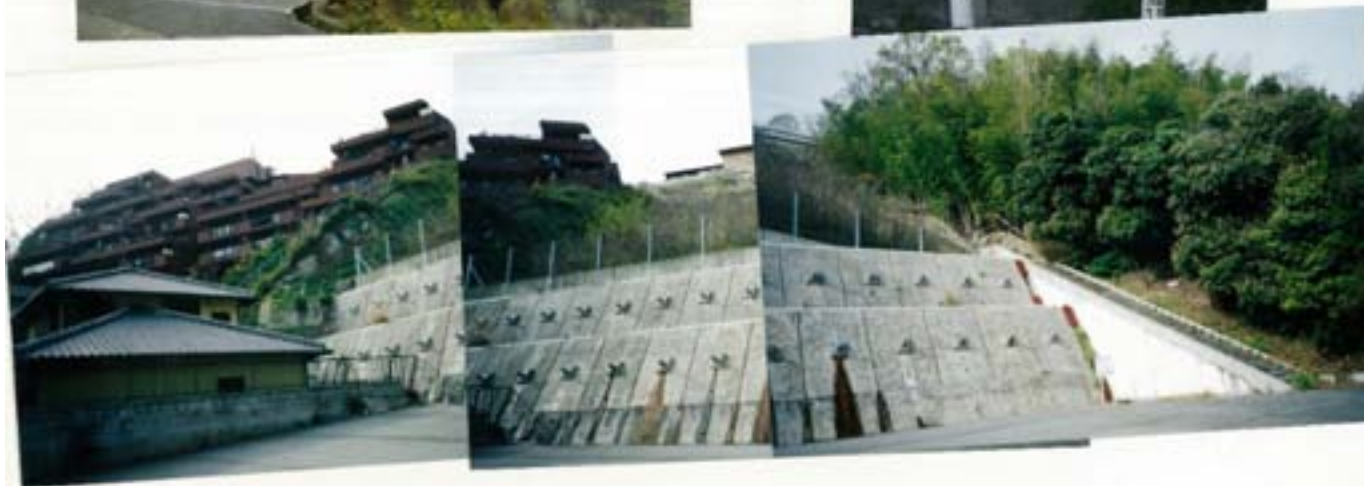
末端斜面の地すべり恒久対策状況(アンカー工)(2006.11.23)。 * 地すべり防止区域(西岡本地区)。
