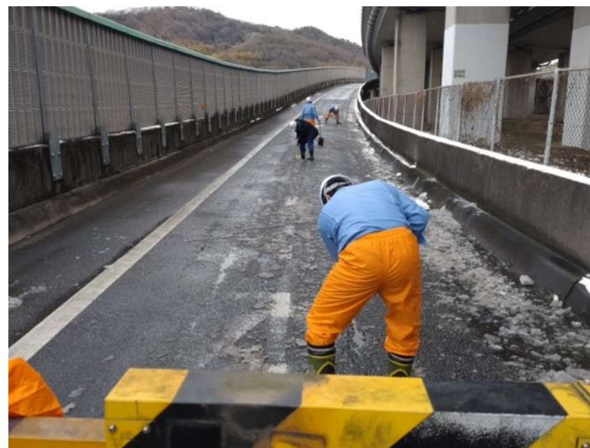
国道2号バイパス(兵庫)では、交通開放のため凍結箇所の対応を人力で実施
