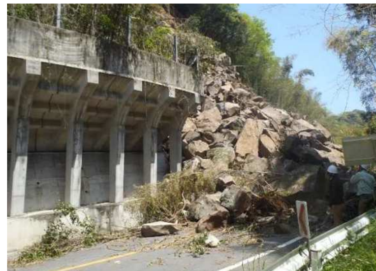
災害時における道路被害の事例
