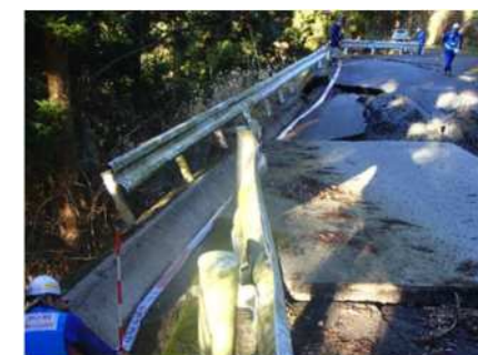
長野県北部地震における調査事例
