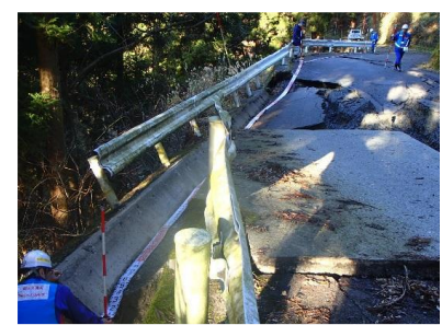
長野県北部地震における調査事例
