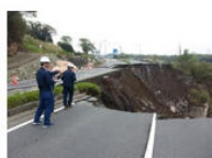
道路崩落により切断された中継 光ケーブル
