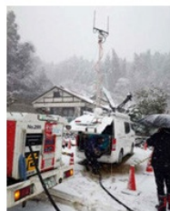
移動基地局車の電源確保
