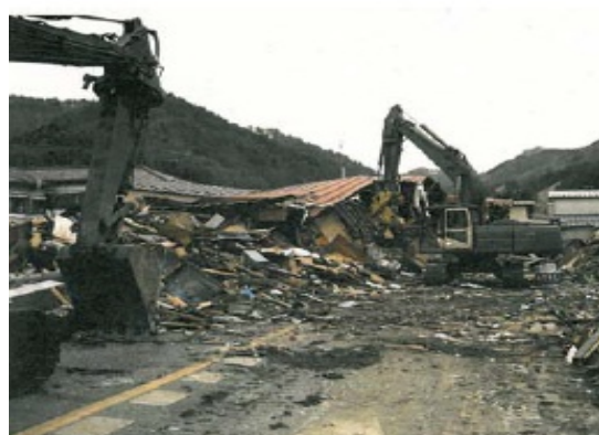
写真 3-2 倒壊建物等の瓦礫
