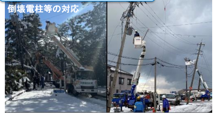
出典) 北陸電力送配電公式X (令和6年能登半島地震における活動)
