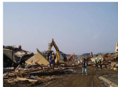
道路脇への山積による車線確保
