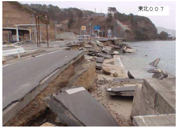
写真 海岸擁壁の崩壊状況 (東日本大震災での被災事例)
