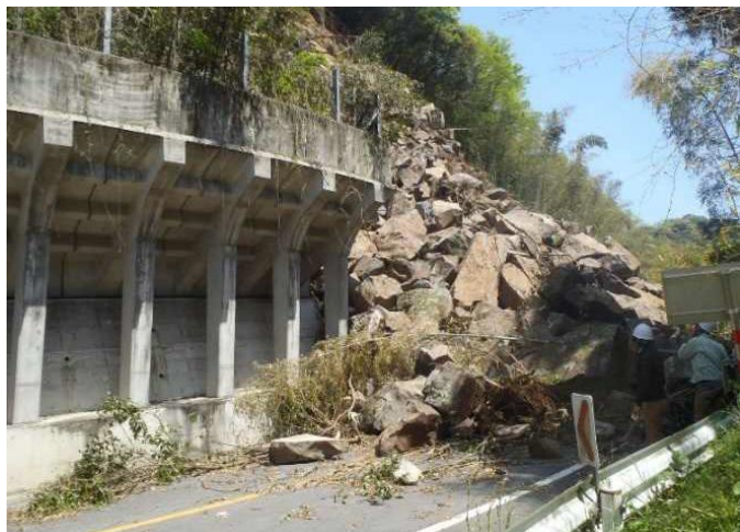
災害時における道路被害の事例
