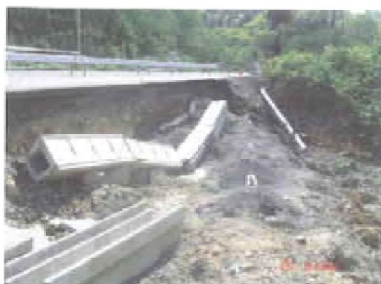
写真 3-5 盛土法面の崩壊状況（東日本大震災での被災事例）
