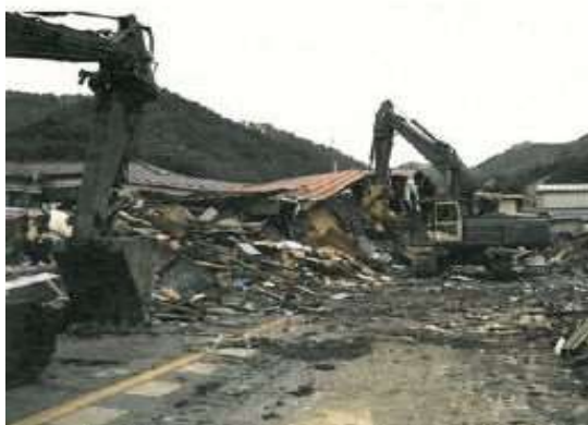
写真 3-2 倒壊建物等の瓦礫
