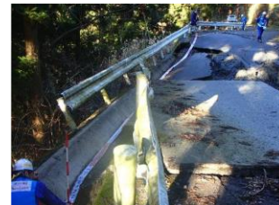
長野県北部地震における調査事例
