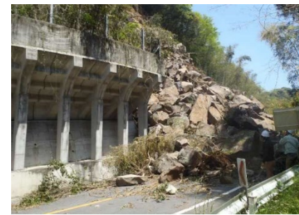
被災状況「落石・岩盤崩壊」の写真
