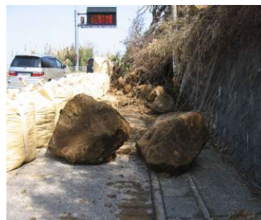
被災状況「落石」の写真
