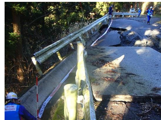
長野県北部地震における調査事例
