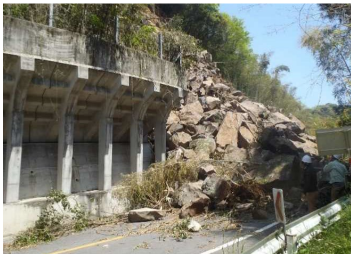
災害時における道路被害の事例
