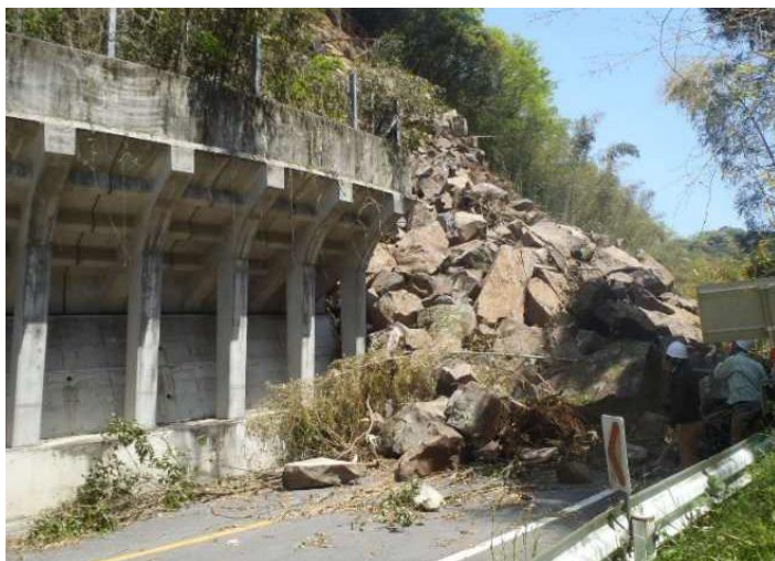
災害時における道路被害の事例
