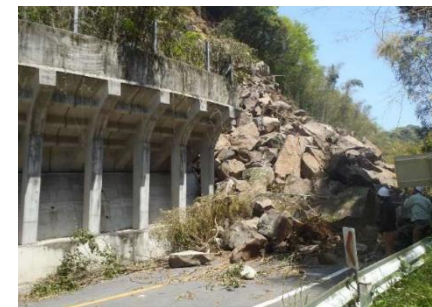
被災状況「落石・岩盤崩壊」の写真
