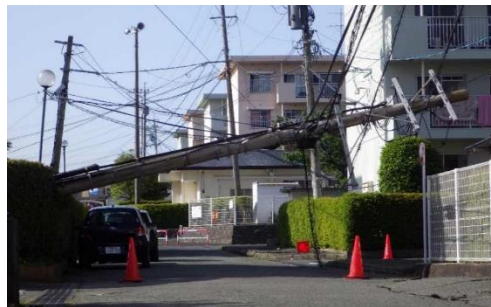
被災状況「電柱の倒壊」の写真
