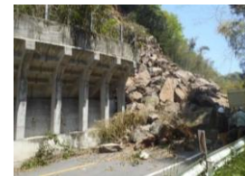
被災状況「落石・岩盤崩壊」の写真
