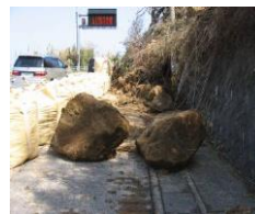
被災状況「落石」の写真
