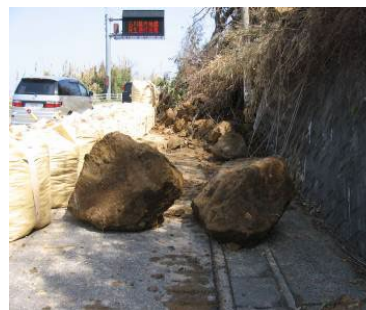
被災状況「落石」の写真
