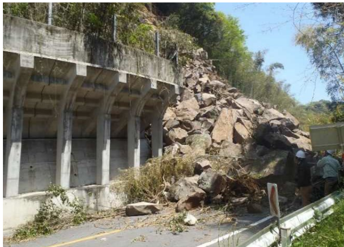
災害時における道路被害の事例
