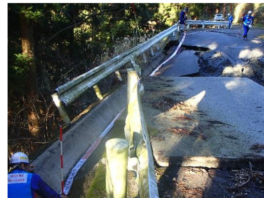
長野県北部地震における調査事例
