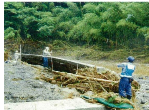
九州北部豪雨災害における調査事例
