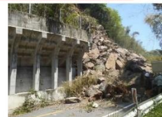
被災状況「落石・岩盤崩壊」の写真
