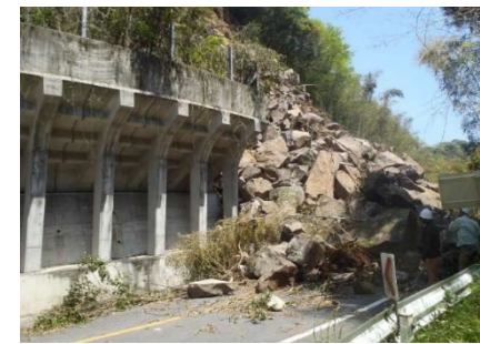
被災状況「落石・岩盤崩壊」の写真
