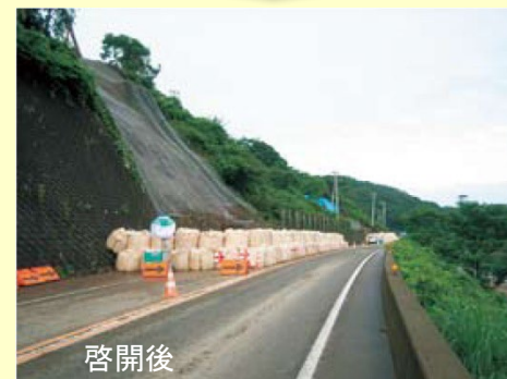
道路啓開状況（新潟県上越市長浜）
