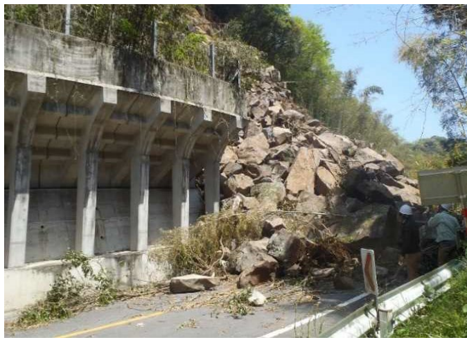
災害時における道路被害の事例
