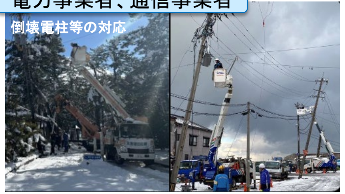
出典：北陸電力送配電公式X（令和6年能登半島地震における活動）
