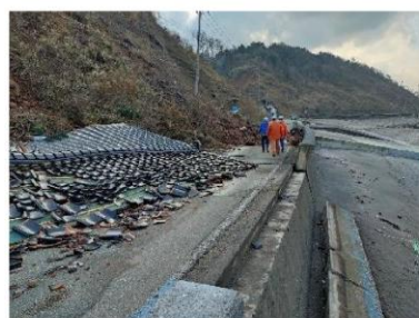
沿道建物倒壊箇所
