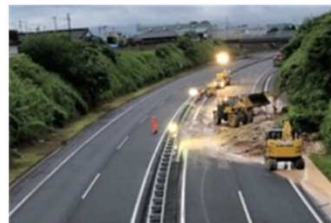
九州自動車道(横川～満辺鹿児島空港)の被害状況
