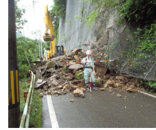
【写真②】 国道168号崩落状況 (H24.6)
