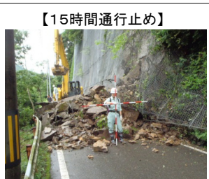
【写真②】 国道168号崩落状況(H24.6)
