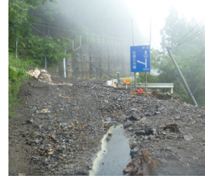
【写真①】 国道168号崩落状況 (H23.9)
