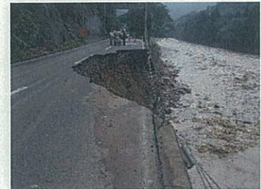
▲国道158号 【災害による崩落状況】
