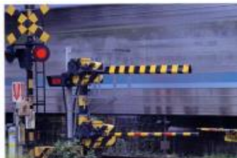
大型遮断機 +二段型遮断装置
