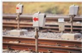
踏切支障報知装置
