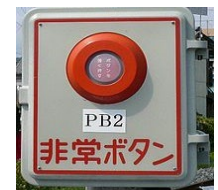
非常押しボタン
