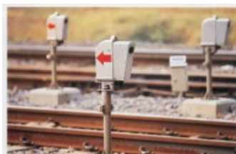
踏切支障報知装置
