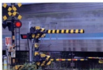
大型遮断機 +二段型遮断装置
