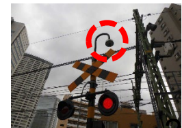
踏切監視用カメラ
