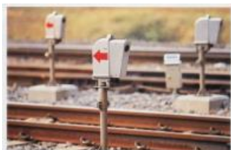
踏切支障報知装置
