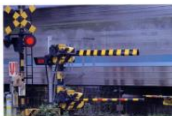
大型遮断機 +二段型遮断装置
