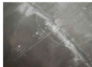
閉合ひび割れ (うき)
