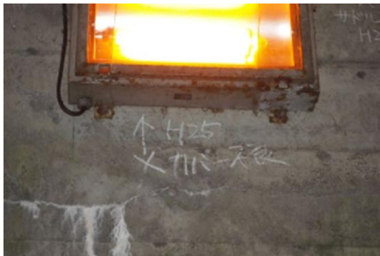
附属物（照明灯具の不良）
