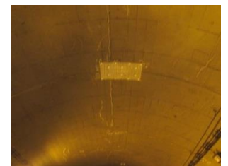
剥落防止ネット
