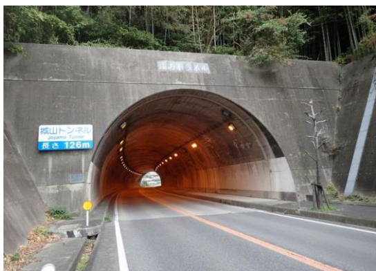
国道28号 城山トンネル L=126m 近畿地方整備局で最初のNATM施工（1982年）
