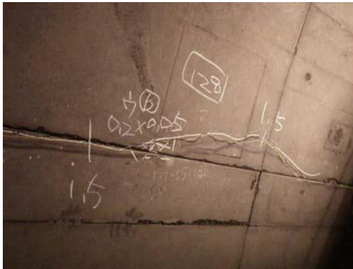
覆工のひび割れ
