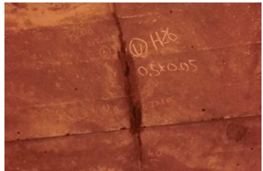
早期に剥落危険箇所を措置
