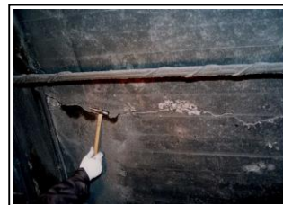
コンクリートの剥離
