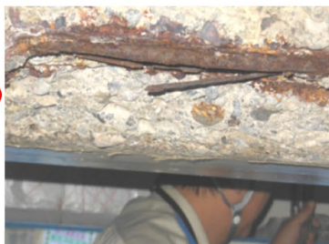
PC鋼線の破断 (塩害)
