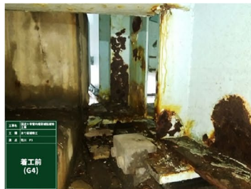
鋼主桁端部の腐食
