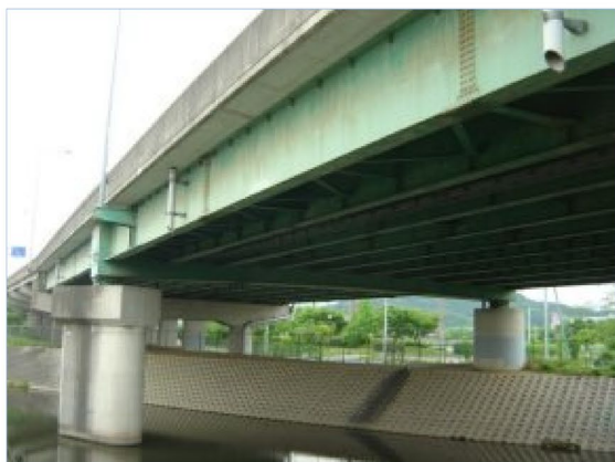
防食機能の劣化
