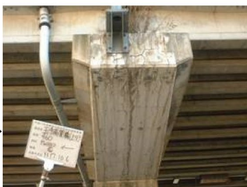
橋脚梁部のひびわれ (アルカリ骨材反応や 中性化)
