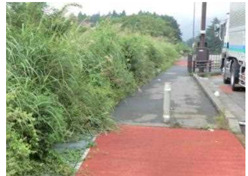
草木が生い茂る歩道
