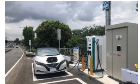
実験中の路上EV充電機器 (横浜市)
