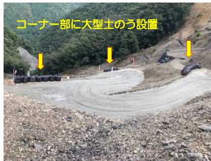
写真 5. 転落防止設備
