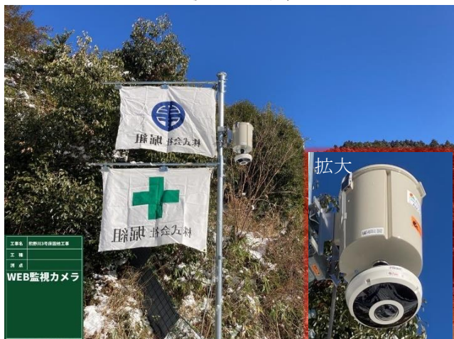
WEB監視カメラ設置
