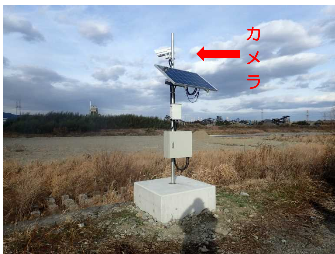
写真-4 簡易型河川監視カメラ (員弁川)
