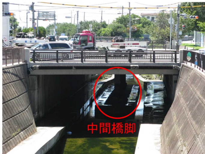
写真-1 若宮橋（改修前）
