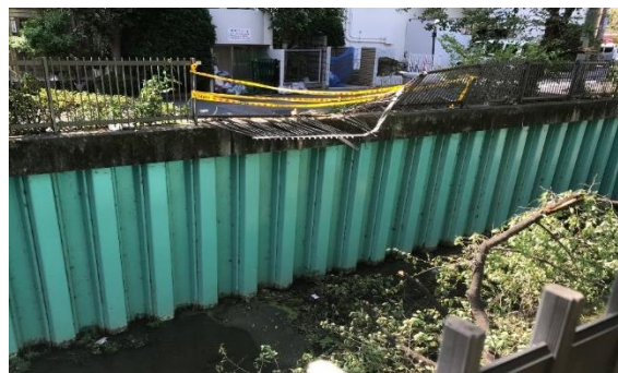
図-3 倒木による転落防止柵の損傷（今川）
