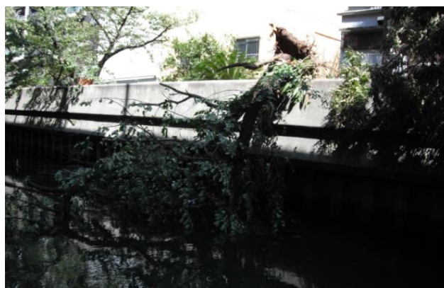
図-4 宅地側へ傾いている樹木（東横堀川）
