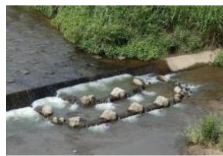
魚道整備（八代水門）
