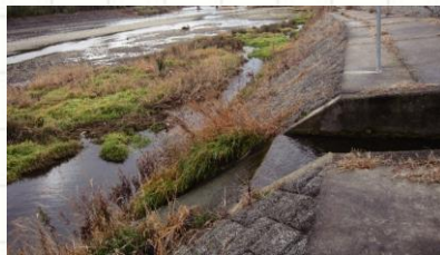
流域との連続性が分断された樋門
