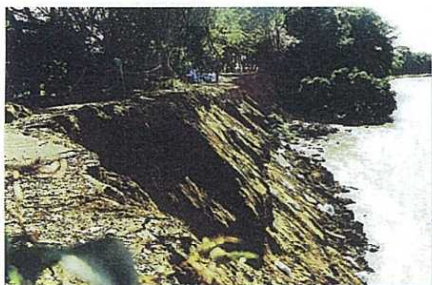
堤防の侵食 (平成6年9月)
