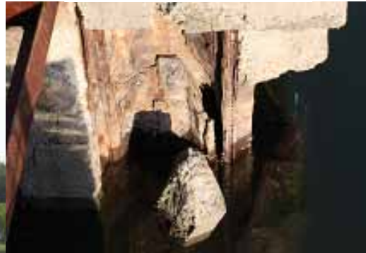
矢板腐食状況
