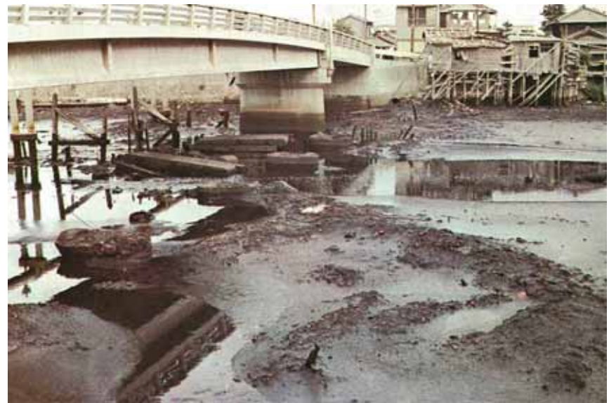
ヘドロ堆積状況
