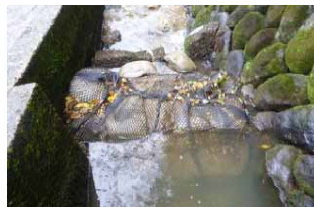
下流側隔壁間土のう(流失なし)
