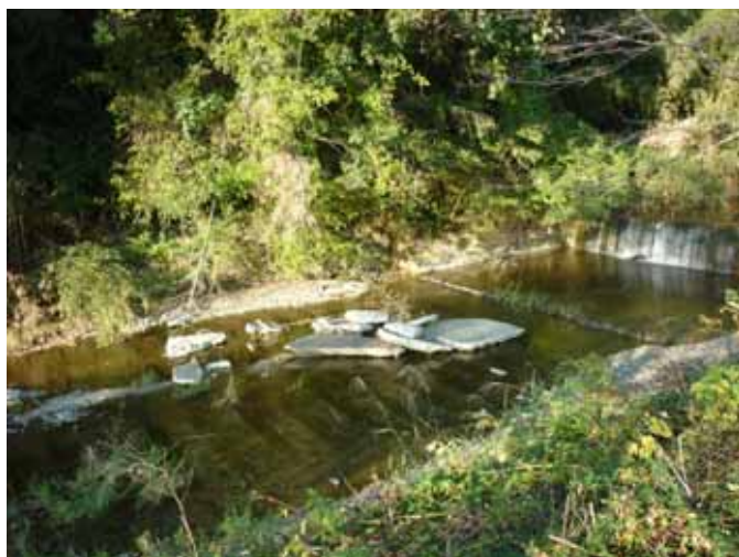
落差工の老朽化 落差工により魚の遡上が不可能
