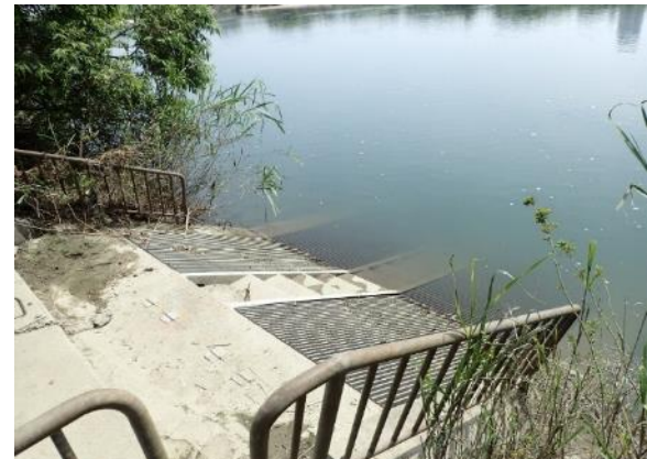
揚水ポンプ (取水口)
