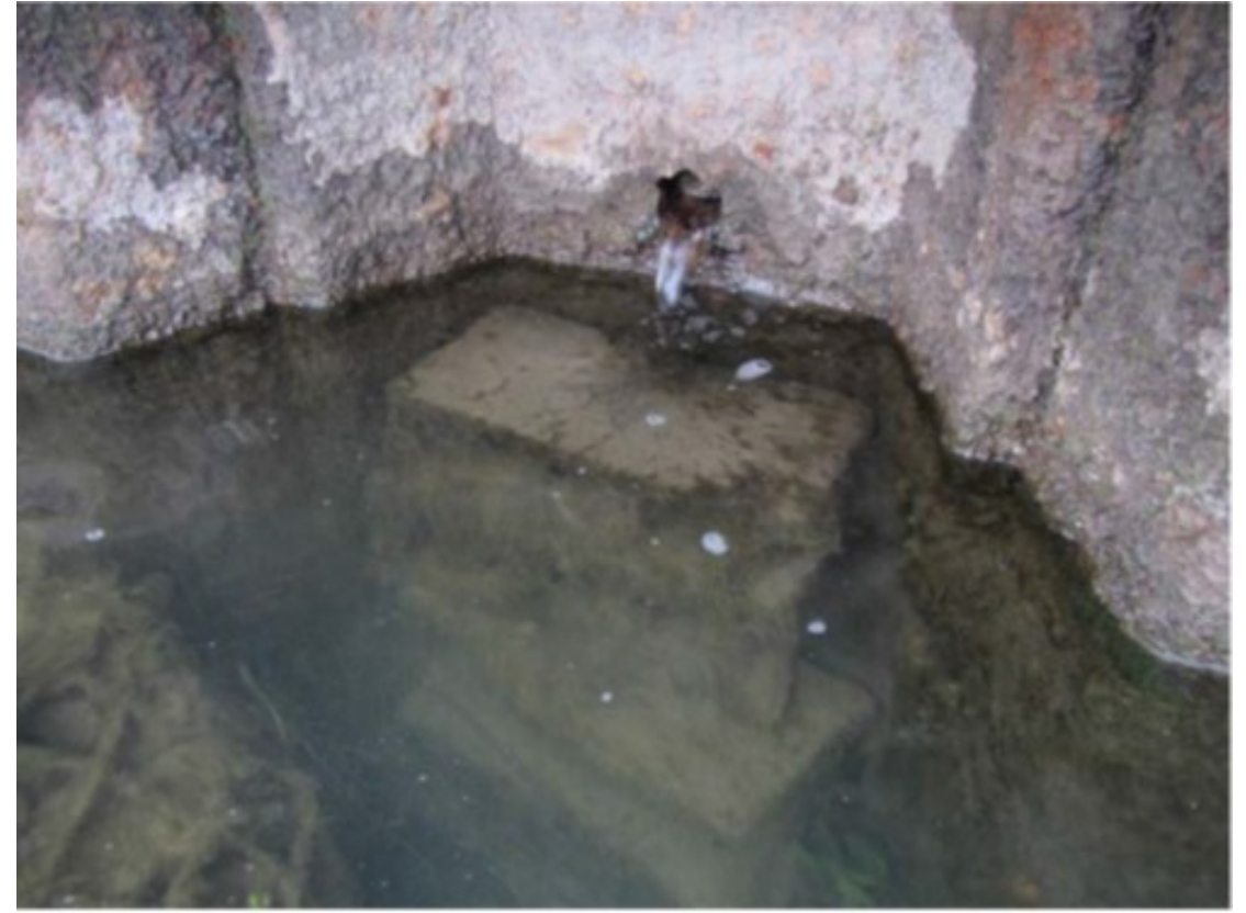
通水孔から湧水がでている状況
