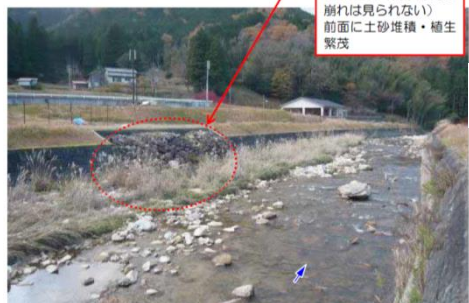
湾曲部に土砂が堆積し、植生が繁茂している。
